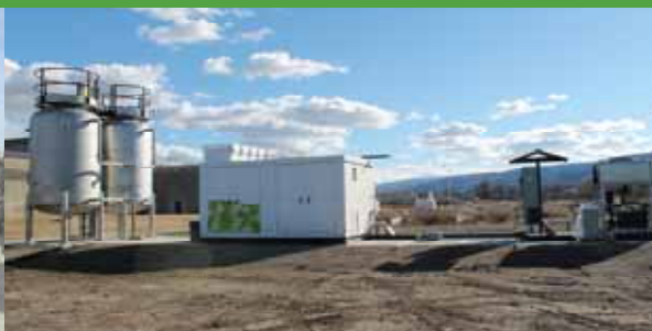
PERSIGO WWTP, CO
